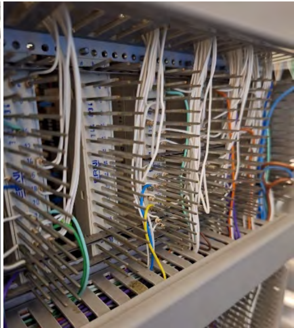
Circuits de commande électrique – télégestion
