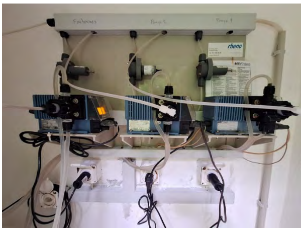
Pompes doseuses du chlore
